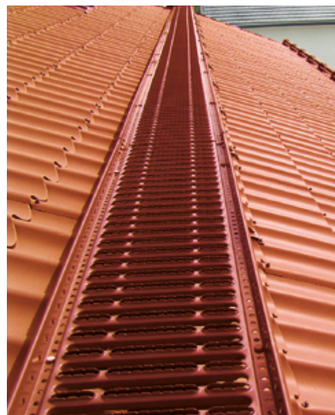
Lapetikas ja kattosilta tukevat turvallisempaa liikkumista katolla.
