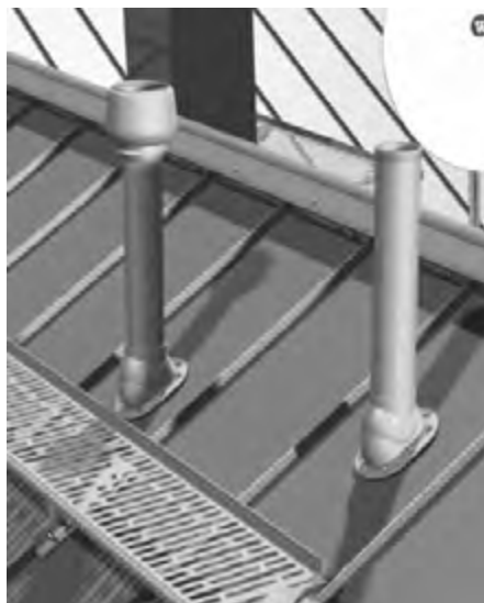
Kuva 39. Läpivientielementtien sijainti lappeella.
