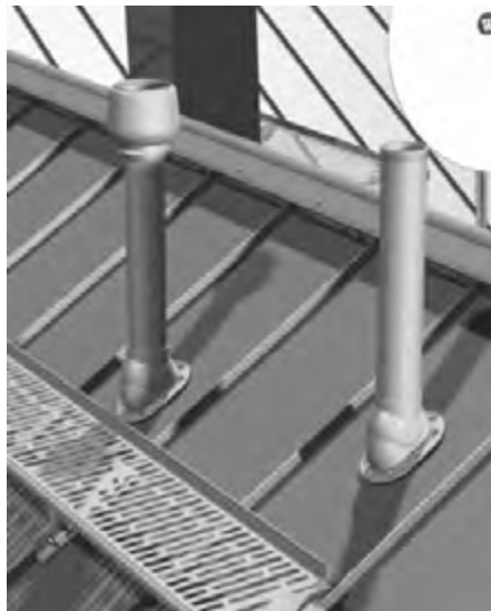
Kuva 39. Läpivientielementtien sijainti lappeella.
