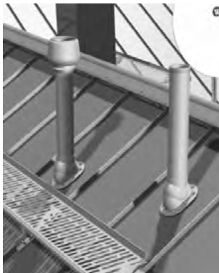
Kuva 39. Läpivientielementtien sijainti lappeella.
